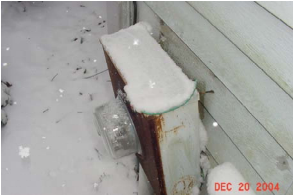
Loose meter box
