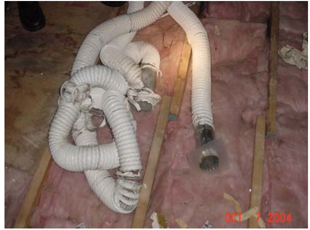
Bathroom fan vent
