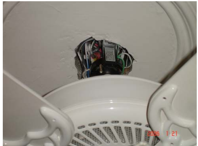
UNSAFE paddle fan wiring
